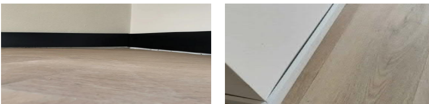
Let Op! Glooiingen in vloer en wanden zorgen voor kieren bij het afmonteren van plinten
